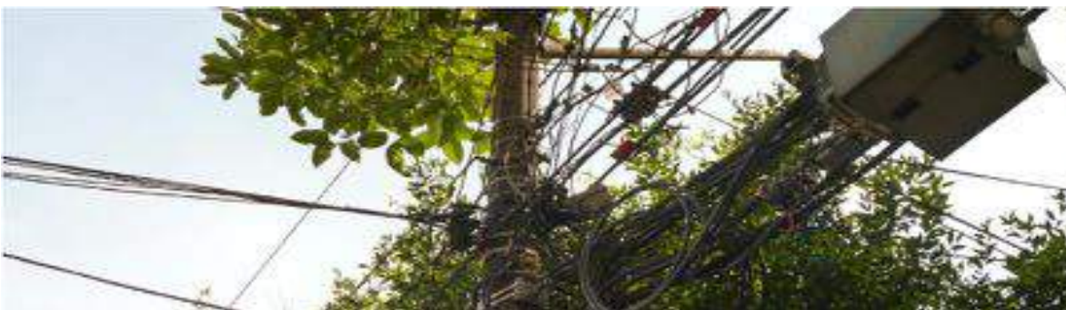
Figura 155. Conflicto con infraestructura de telecomunicaciones
