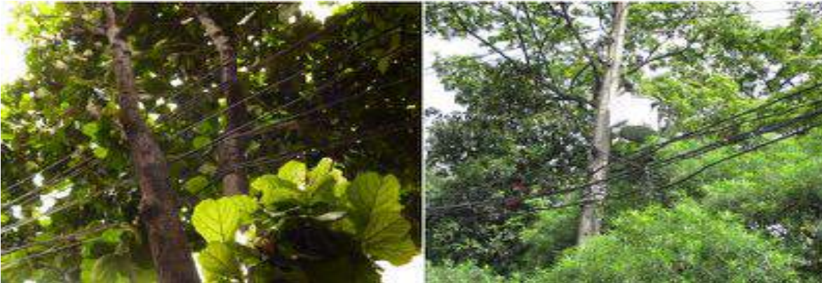
Figura 154. Izq. Red de baja tensión. Der. Infraestructura eléctrica asociada a postes
