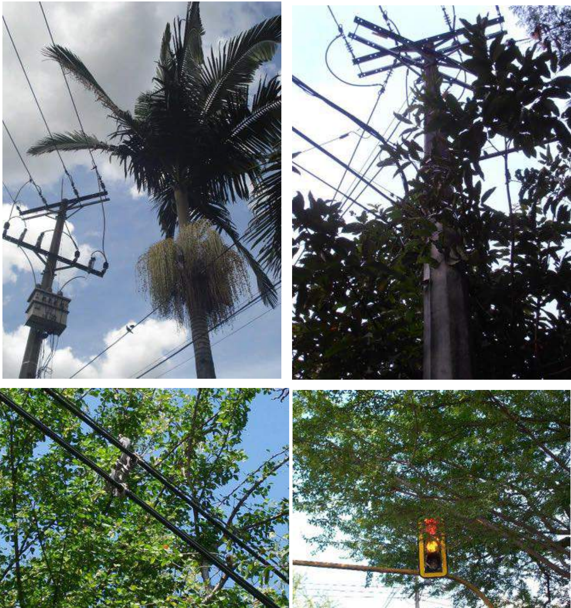
Figura 62. Conflictos entre la vegetación y los sistemas urbanos. a) con red de distribución abierta, b) y c) con red de distribución compacta y d) con semáforo
