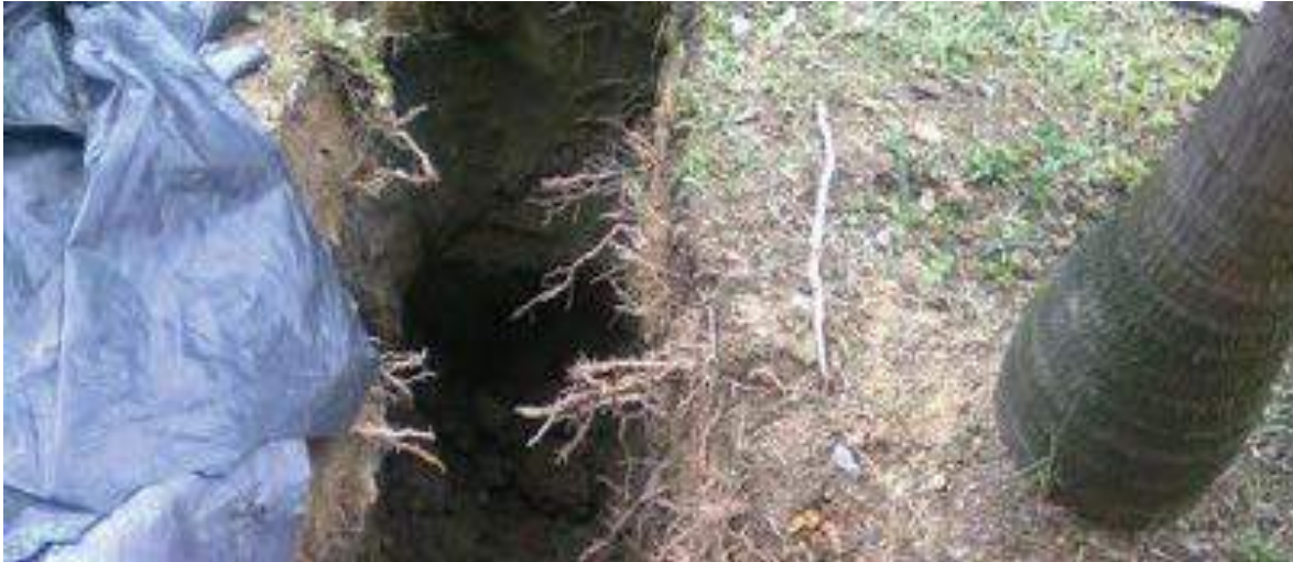
Figura 160. Evidencia de conflicto entre el sistema radicular de una palma y el sistema subterráneo
