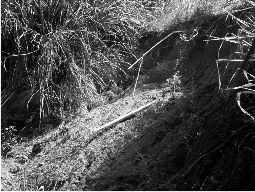
Figura 3: Cabeceira do desmoronamento da encosta do Morro da Carioca, Angra dos Reis, RJ.
