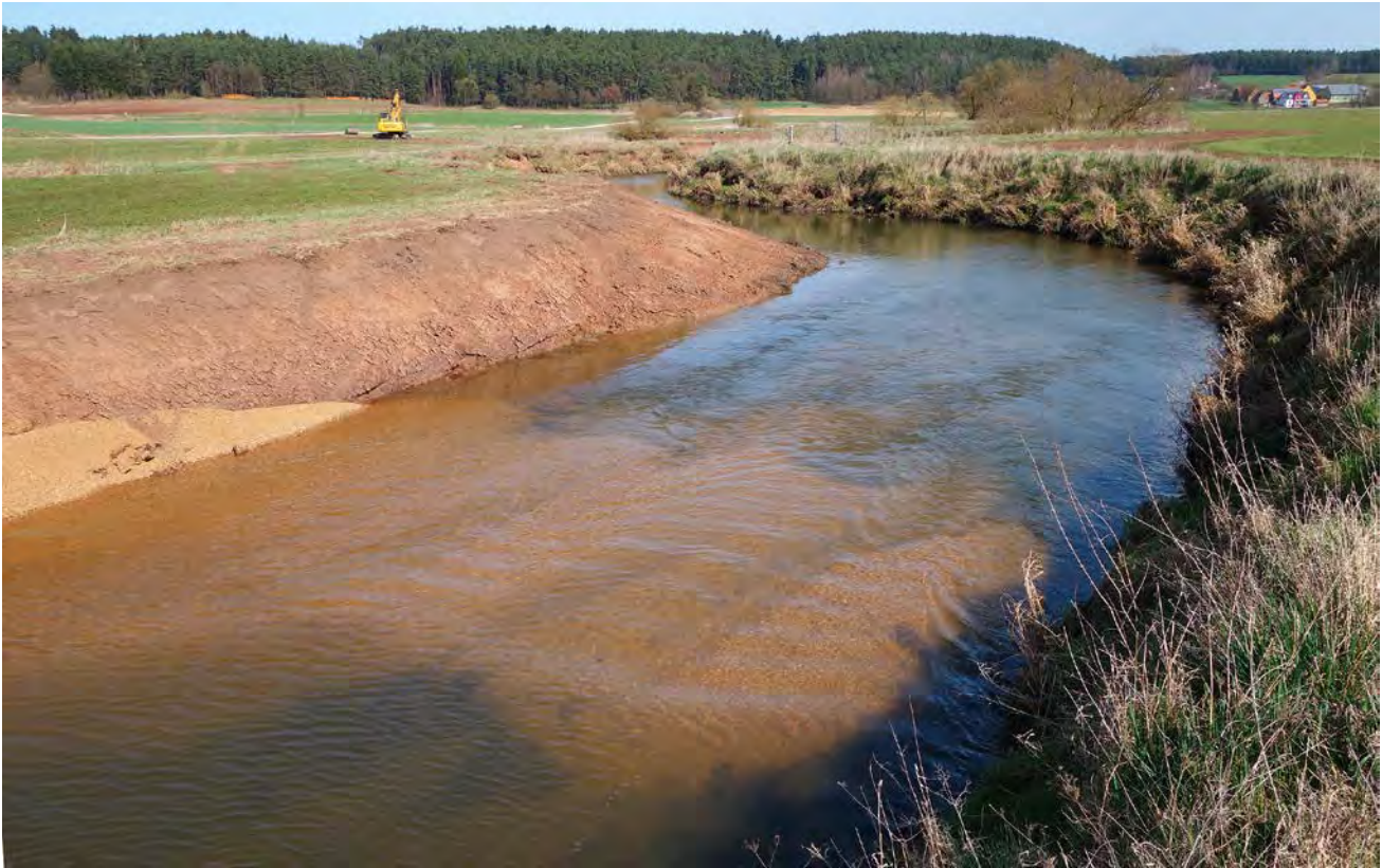
Abb. 12: Blick auf eine Kies-Einbringstelle bei Bechhofen kurz nach der Maßnahme – eine langsamere Fließgeschwindigkeit ist schon erkennbar.
