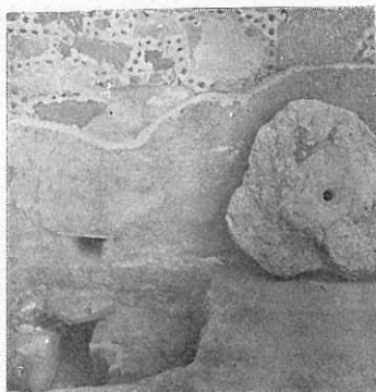
FIG. 5. Acercamiento del sumidero para poder apreciar el orificio de salida del conducto que desagua la habitación contigua, la piedra horadada que cubría los conductos y el arranque del conducto que llega hasta el alcantarillado general.
