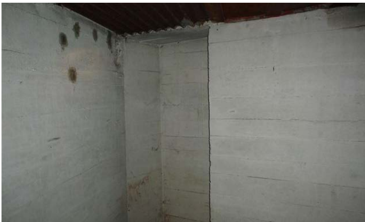
Foto. In deze kelderruimte zijn duidelijk extra schuilmogelijkheden nodig. Het boren van gaten in het plafond geniet de voorkeur boven het ophangen van holle bakstenen.
