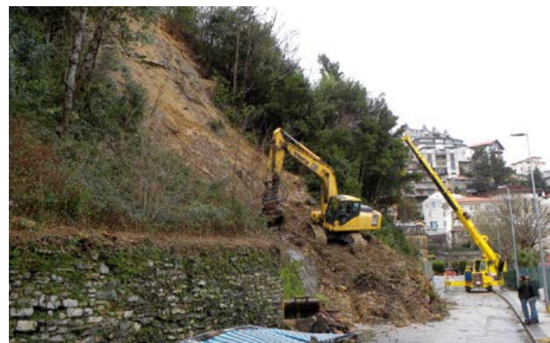
Figura 25. Desprendimiento de la ladera en la antigua cantera de Arbizketa o Arrobi en enero de 2013.
