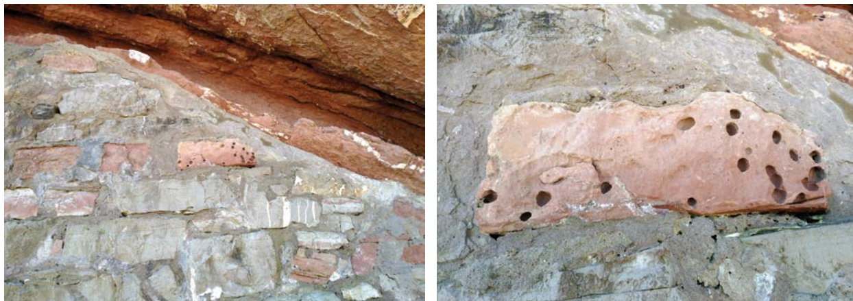
Figura 17. Detalle de muro de costa en Loretopea, caliza roja afectada con lithófagas.
