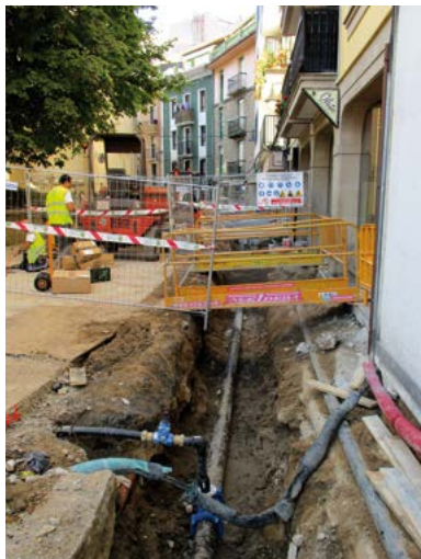
Perspectiva de una de las zanjas abiertas en la calle San Frantzisko kalea (Zarautz).
