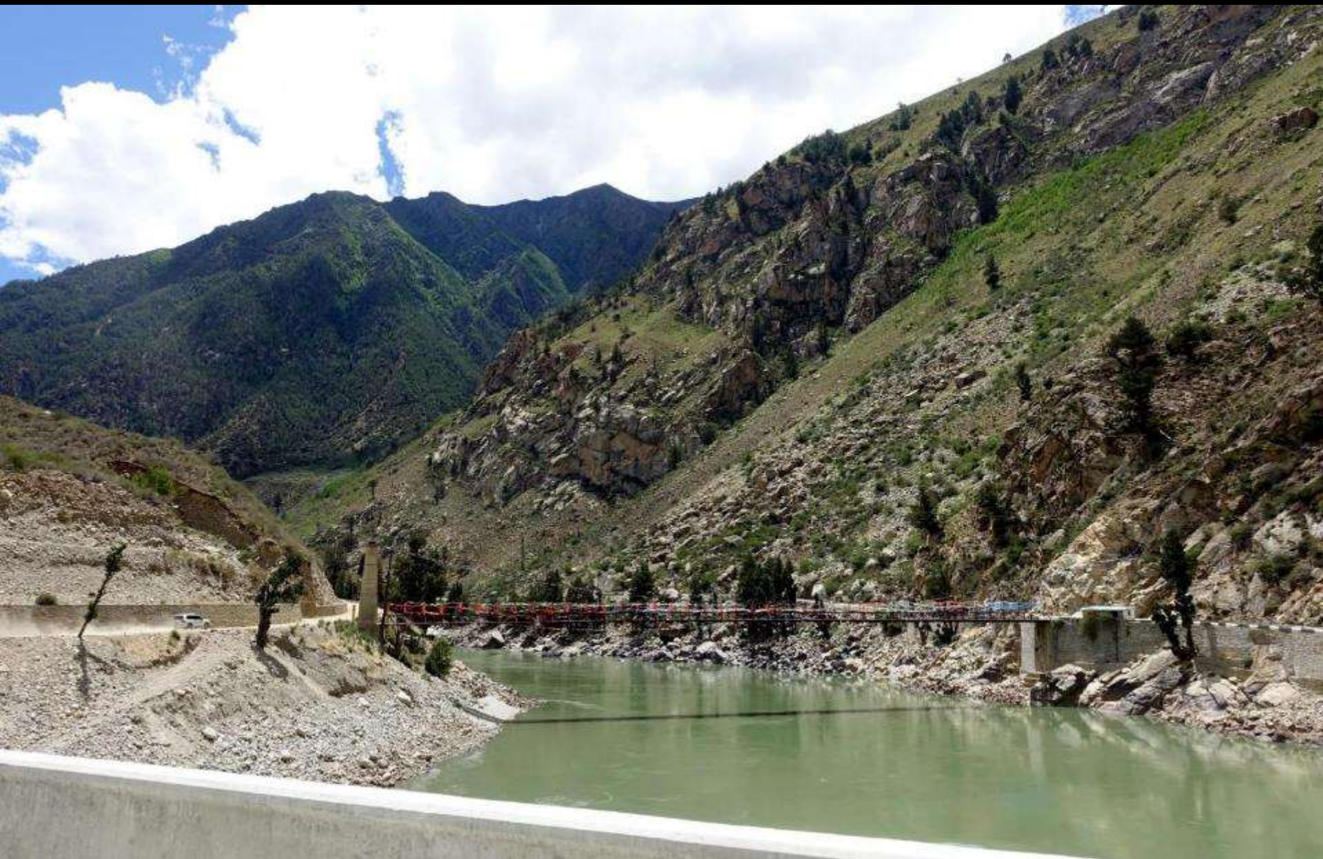
Vallée du Yarlung Tsangpo (Yalun Zangbu) : route Nang (Lang) – Gyatsa (Jiacha): pont en construction
