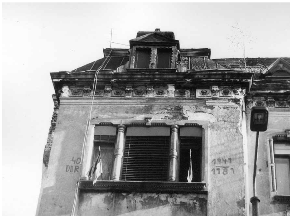
Stark baufälliges Wohnhaus in der Pölitzstraße in Leipzig-Gohlis im Sommer 1989. Foto: Archiv Bürgerbewegung Leipzig e. V./ Burkhard Starke
