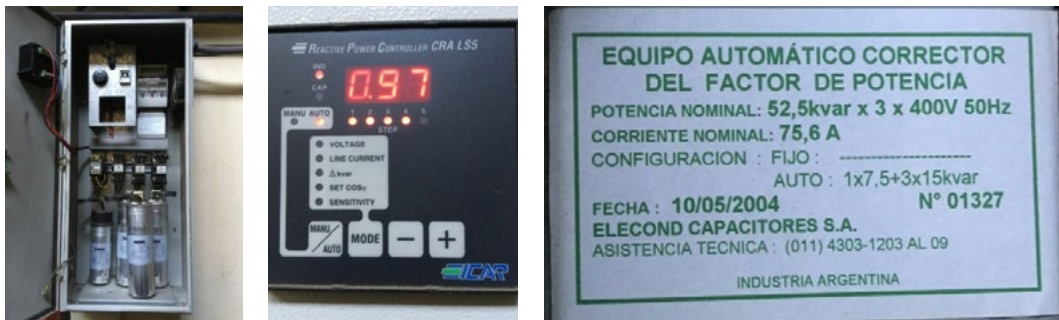
Imagen 25: Banco de capacitores. (Fuente: ADIMRA)
