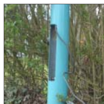
Cent kilos de câble pour l'éclairage public ont été dérobés.
