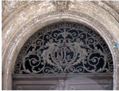
Grilles ornementales : état avant restauration. Les modèles sur le catalogue du Val d'Osne retrouvés par E. Robert-Dehault
