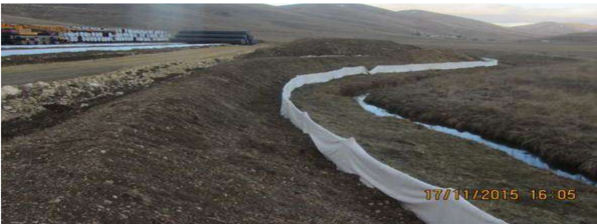
Şekil III.2.19.69. Üst Toprak Depolama Alanlarında, Koruma Amaçlı Gerçekleştirilen Silt Kafes Uygulamaları, Fotoğraflar: B. ERDEM, 2015
