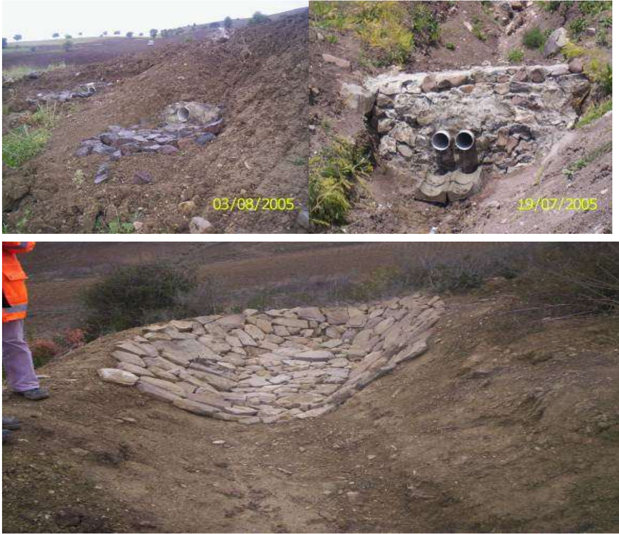
Şekil III.2.19.90. Kalıcı Erozyon Kontrol Önlemleri, Su Tahliye/Boşaltım Yapıları, Fotoğraflar: B. ERDEM, 2005
