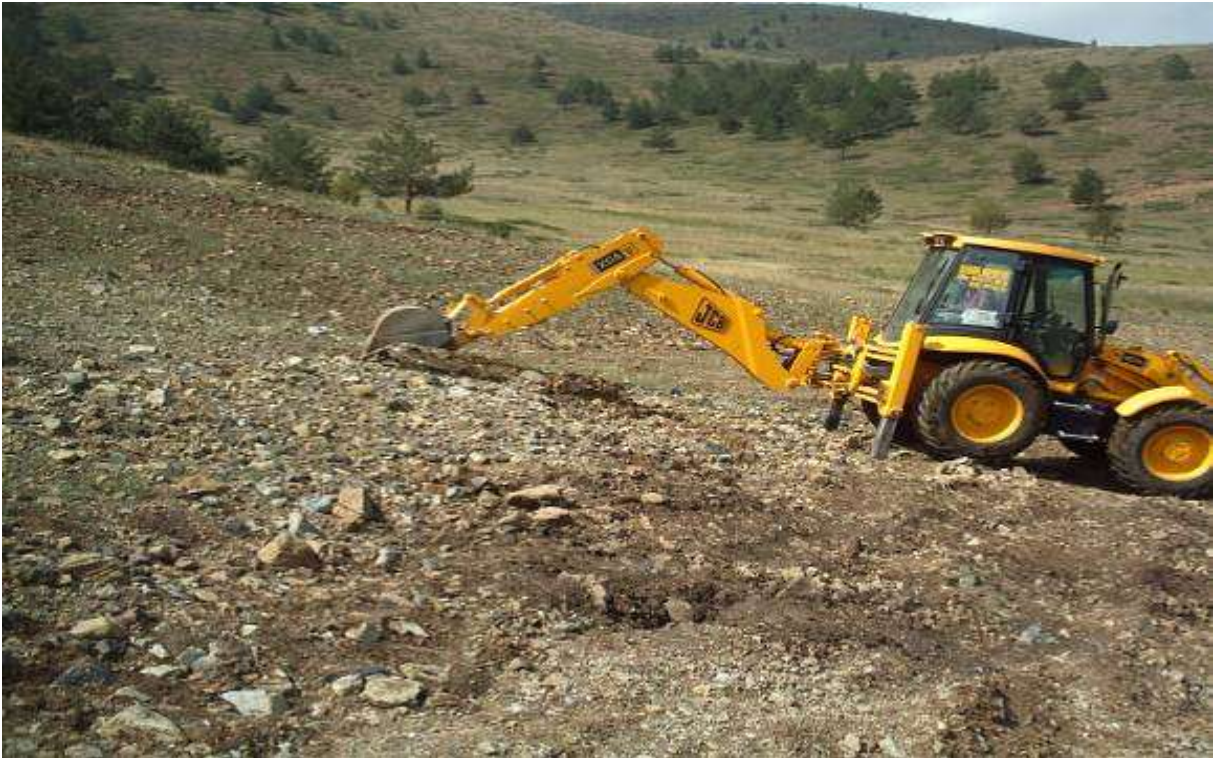
Şekil III.2.19.110. İletim Borusu Güzergahı Üzerinde Meydana Gelen Bozulmaların İş Makinesi ile Onarılması, Fotoğraf: B. ERDEM, 2006
