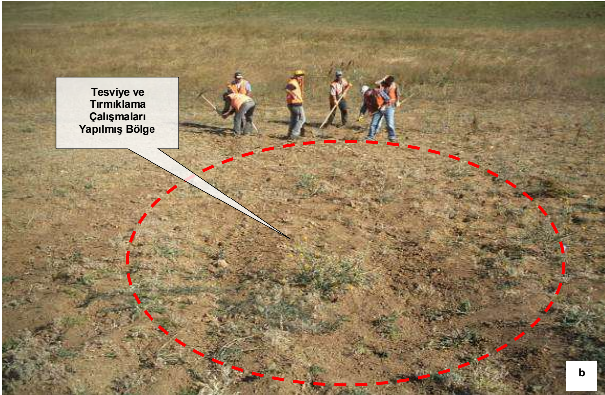
Şekil III.2.19.108. a-, b- Su Erozyonuna Maruz Kalmış Bir Alanda İnsan Gücü İle Gerçekleştirilen Onarım Çalışmaları, Fotoğraflar: B. ERDEM, 2006
