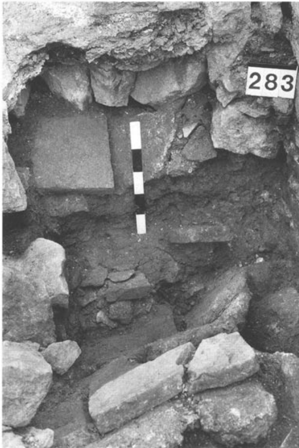
Abb. 5: Augst BL, E. Frey AG (Grabung 1999.60). Der Abwasserkanal an der Westseite des Badanbaus ist vom sich von unten her ausweitenden Einbruchtrichter förmlich «verschlungen» worden. Blick von Süden auf die zentrale Einbruchstelle (zur Orientierung vgl. Abb. 3). Der Jalon steht ungefähr senkrecht!.
