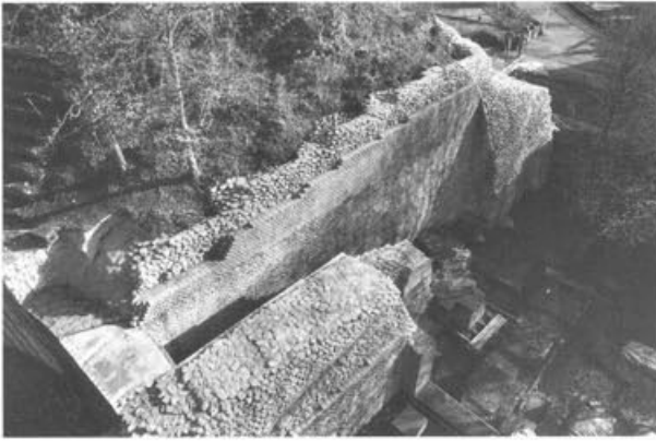
Abb. 32: Augst, Theatersanierung (Grabung 1999.55). Blick auf die Südwestecke des Theaters mit der aufgehöhten Caveaabschlussmauer-Süd nach erfolgter Sanierung.
