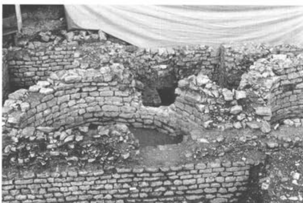
Abb. 40: Augst, E. Frey AG (Grabung 1997.60/1998.60/1999.60). Die jüngere Hangstützmauer 3/29 (Abb. 38,A; 39, rechts) – frei gelegt und ungeschützt. Ohne Konservierungsmassnahmen (vgl. Abb. 1) wäre diese Mauer nach ein bis zwei Wintern zerstört.
