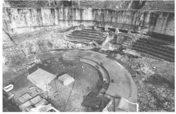
Abb. 39: Augst, Theatersanierung (Grabung 1999.55). Rekonstruktion der Sitzstufen im 1. Zuschauerrang. Blick auf die Orchestra des Theaters nach dem Versetzen der Abdeckplatten aus Sandstein.
