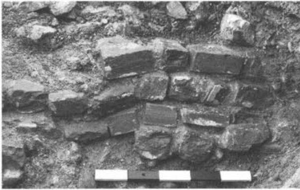
Abb. 28: Augst, Theatersanierung (Grabung 1999.55). Südliche Flügelmauern des Ersten Theaters. Verstärktes Mauerstück von Abb. 25. Ansicht an die oben liegende Mauerchale mit Resten von pietra rasa -Verstrich und sorgfältig angebrachtem Fugenstrich. Die Schale besteht vorwiegend aus Buntsandstein-Handquadern und Mauerquäderchen, die aus einem äusserst dichten, sehr regelmässig brechenden Kalkstein gefertigt sind.
