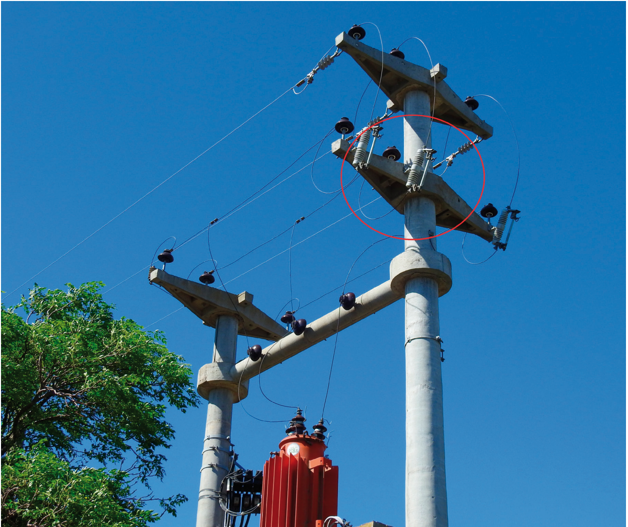
Figura 2: Transformador de energía eléctrica en el cual encontré un nido de Estornino Pinto ( Sturnus vulgaris ) el 6 de noviembre de 2020 a 5 km de la ciudad de Oncativo, Córdoba, Argentina. El círculo rojo indica la zona en la que bajaban los adultos con alimento en el pico, donde se encontraría el nido. Fotografía: Merlo F.
