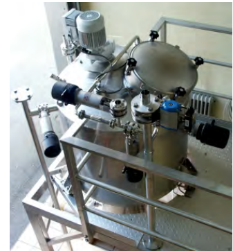
Anmischbehälter mit Inspektionsluke
