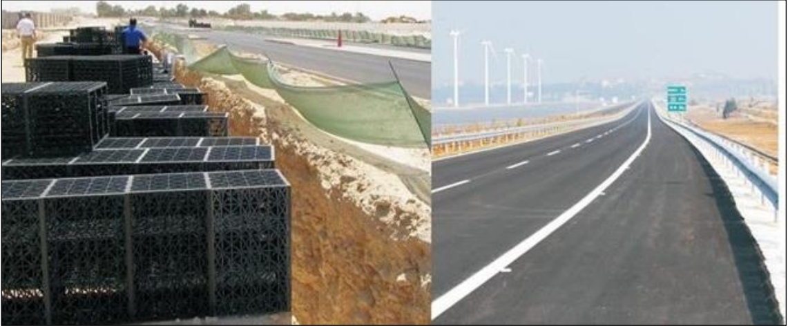
Şekil 16. Yol Kenarlarında Yağmur Sularının Depolanması (Anonim, 2018k)
