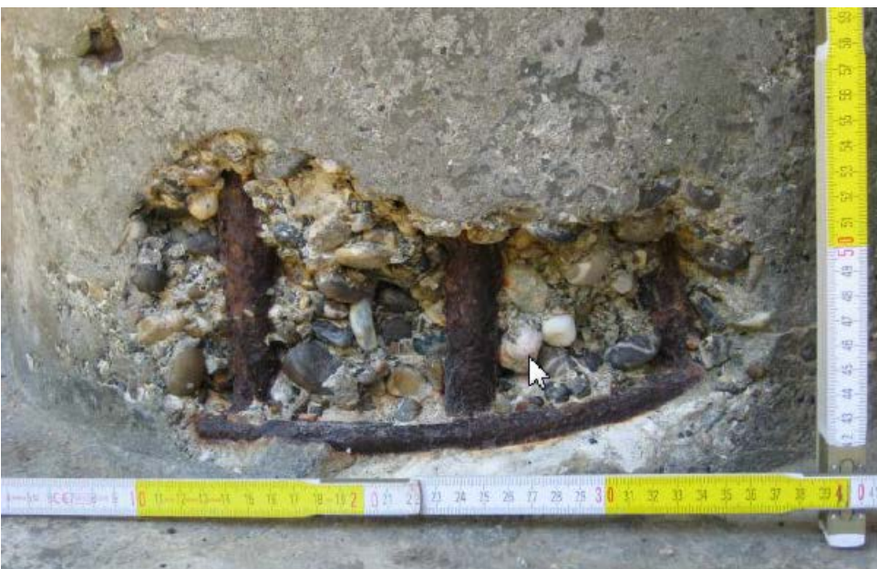
Abb. 09: Freiliegende und rostige Armierung an einem Stützenfuss
