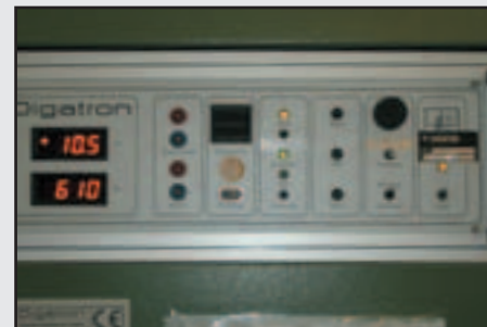
Volle Kontrolle: Die Elektronik steuert die Hochstrom-Orgie.
