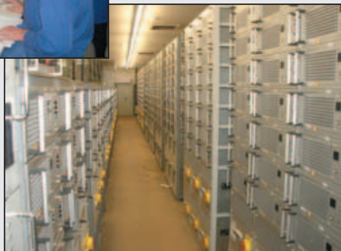
Geballte Ladung: Über 400 Batterien werden bei Varta gleichzeitig computergestützt überwacht.
