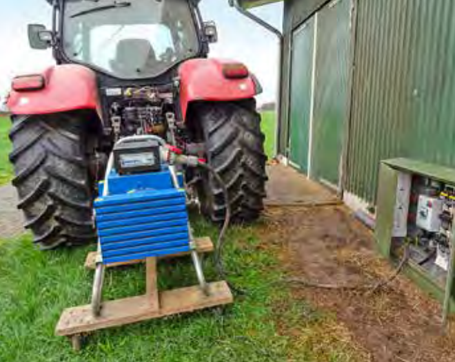
Beim Einsatz eines Notstromaggregates ist auch auf eine ausreichende Kraftstoffversorgung des Schleppers zu achten.
