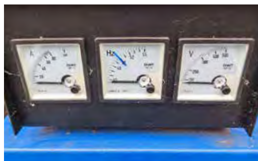
Ein Blick auf die Instrumentenanzeige mit Amperemeter, Frequenzmesser und Voltmeter
