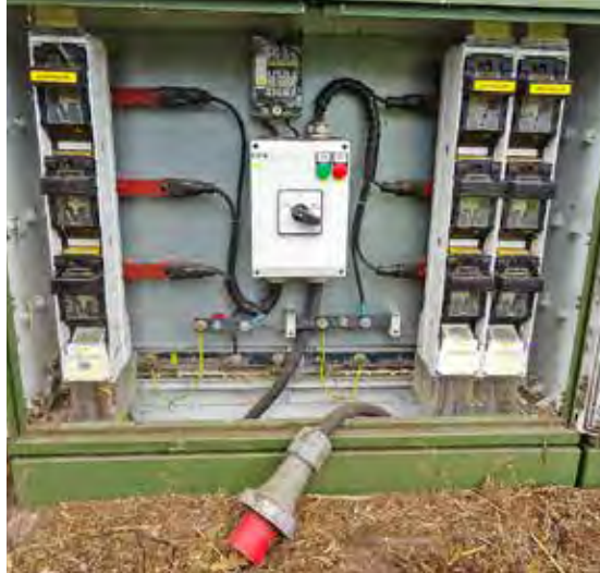
Mittels Netz-O-Notstromschalter (Trenneinrichtung) wird von Netz- auf Ersatzbetrieb umgestellt.
