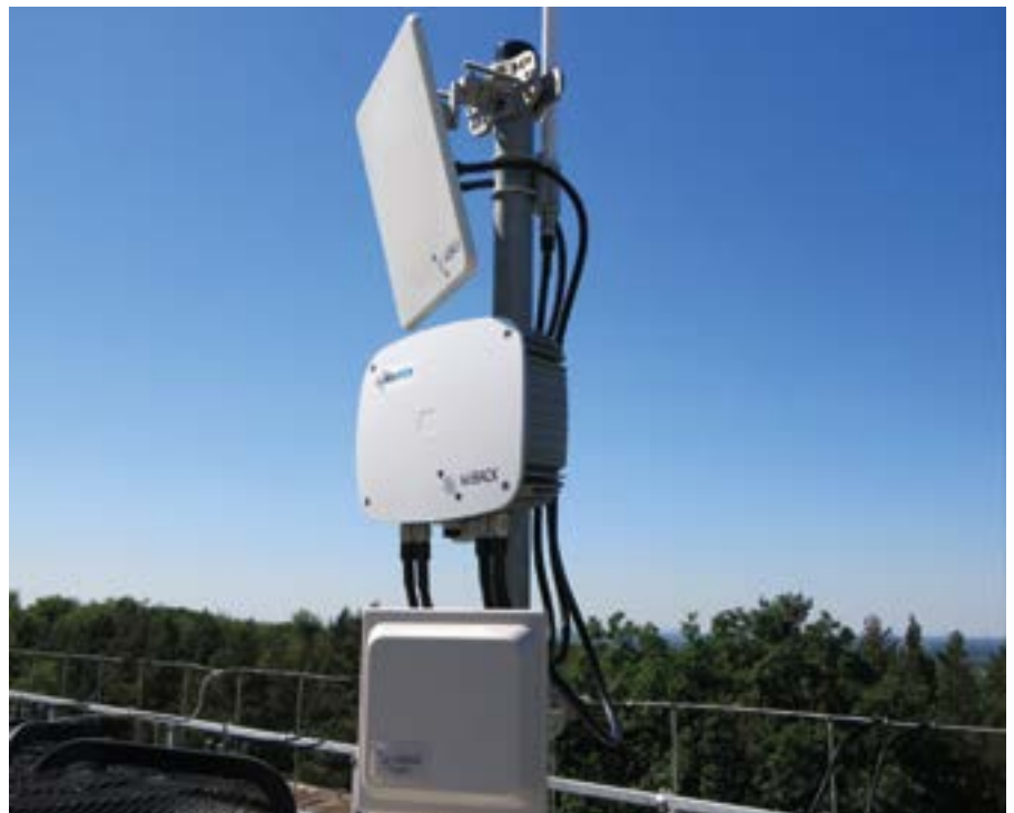
Dieser spezifische Aufbau besteht aus einem „WiBACK“-Knoten, zwei Richtfunk-Antennen (5 GHz) und einer Stab-Antenne für „LoRa“ Sensorik (IoT). (Bild: Fraunhofer FIT)
