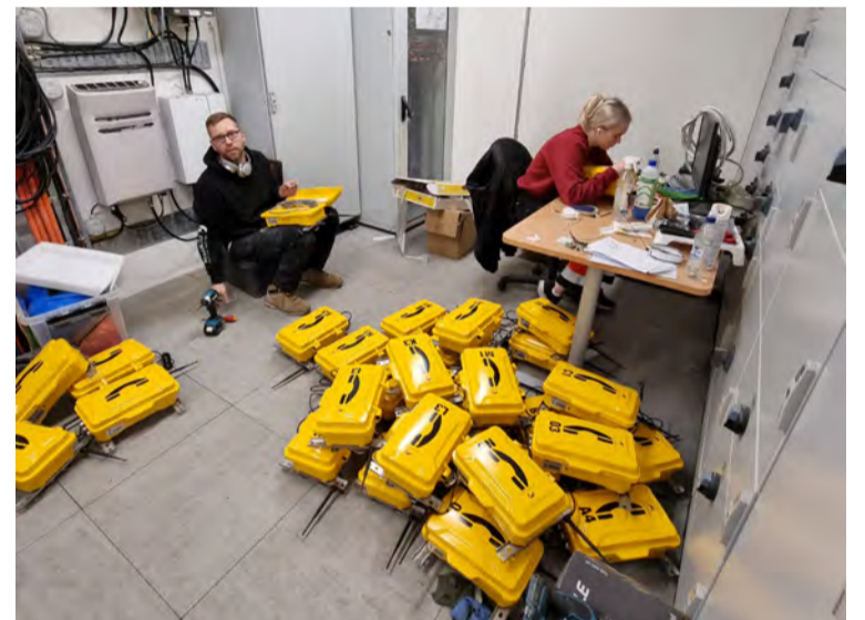
Unnið hefur verið við það síðustu vikur að koma upp fleiri neyðarstöðvum í Vaðlaheiðargöngum, alls verða 60 símar til taks í göngunum en hér er verið að setja þá saman.
