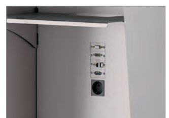
Das Anschlussfeld in der Säule ist intern mit den Anschlüssen im Sockel verbunden
