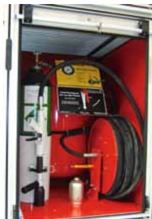
Feuerlöschcontainer von vorne
