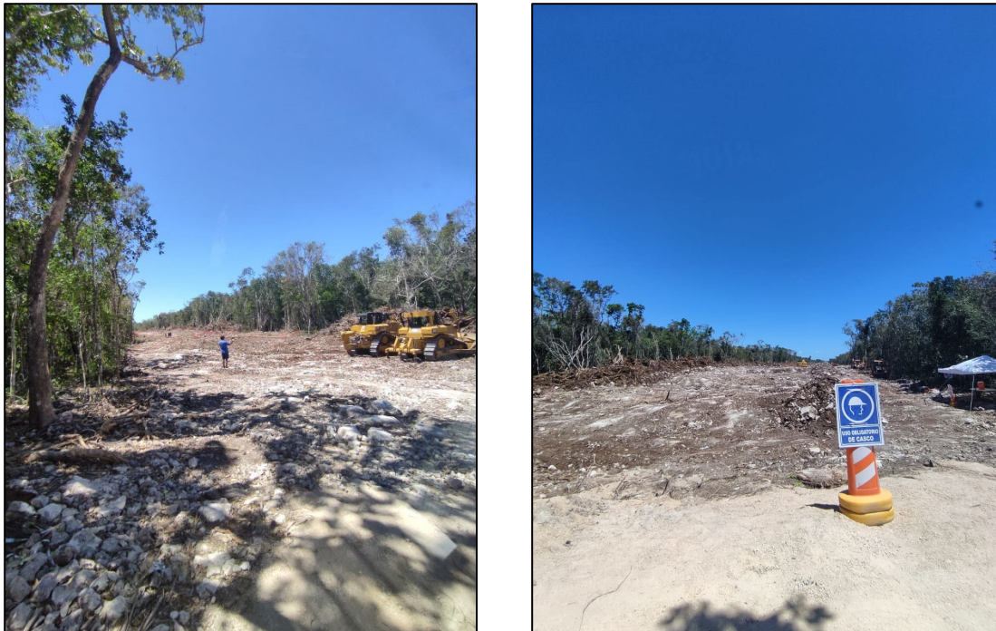
Figura 8. Fotografías tomadas en marzo de 2022, que evidencian el desmonte realizado en el Tren Maya Tramo 5 sur.
