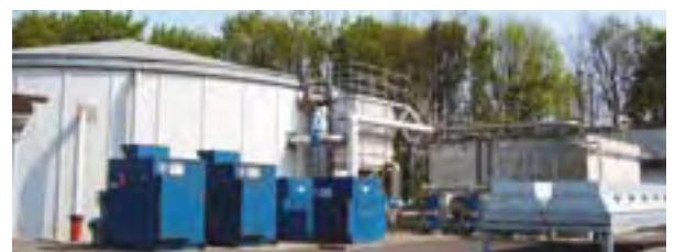
Station de traitement des effluents, Midleton (Irlande).
