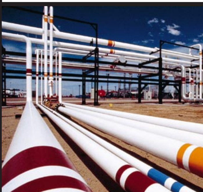
▼ Usine de gaz d'Aguada Pichana, en Argentine
