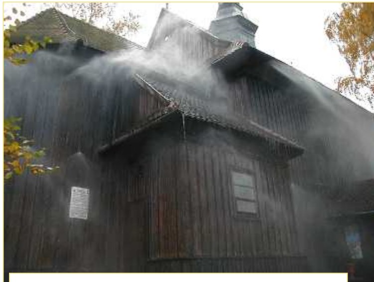
Wasserebellöschanlage an einer Holzkirche
