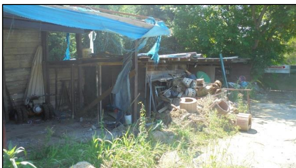
Abb. 14: Unterstände mit Bauschutt .
