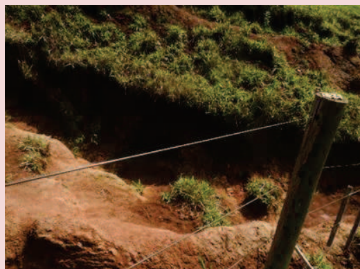
Foto 5-11. Vista da formação de voçorocas na estrada rural abandonada no Sítio Santa Rita.
