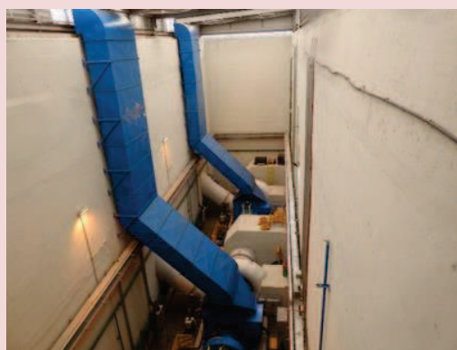
Foto 5-4. Vista interna da casa de Força da PCH Cantú 2.
