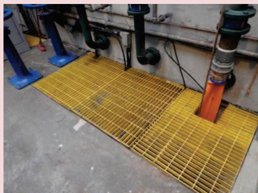
Foto 5-23. Grade com acesso para a caixa SAO na área interna da casa de força da PCH Cantú 2.
