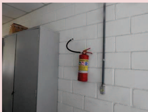
Foto 5-31. Disposição de extintor na área externa da casa de força da PCH Cantú 2 - 2º semestre.
