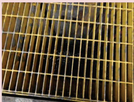
Foto 5-25. Vista interna da Caixa SAO na área interna da casa de força da PCH Cantú 2 - 2º semestre.
