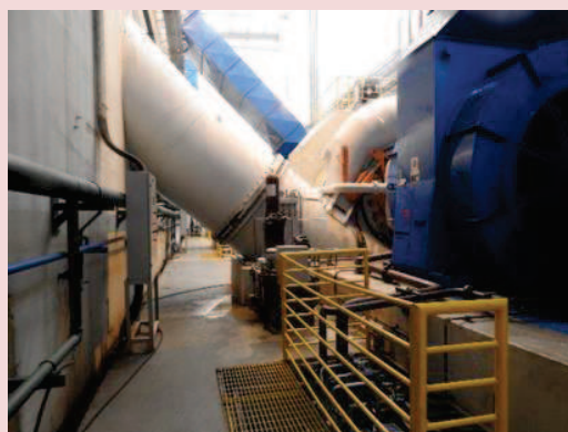
Foto 5-20. Vista das Unidades Geradoras (UG) da casa de força da PCH Cantú 2.
