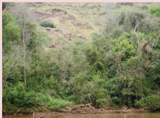
Foto 5-1. Vista frontal de antigo deslizamento de talude na M.E. do reservatório, confrontante ao Rio Azul.
