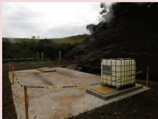
Foto 5-22. Sistema separador água e óleo (Caixa SAO) na área externa da casa de força da PCH Cantú 2 - 2º semestre.
