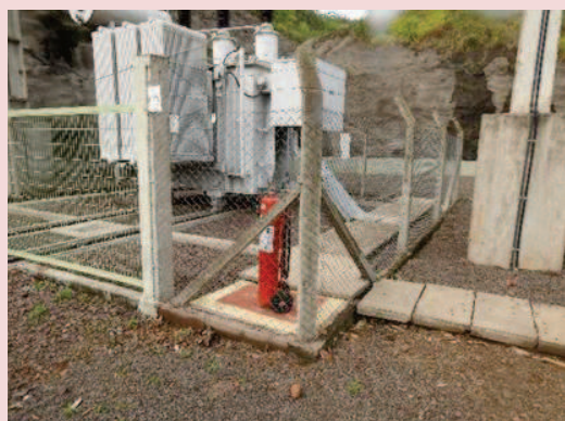
Foto 5-30. Disposição de extintor na área externa da casa de força da PCH Cantú 2 - 2º semestre.
