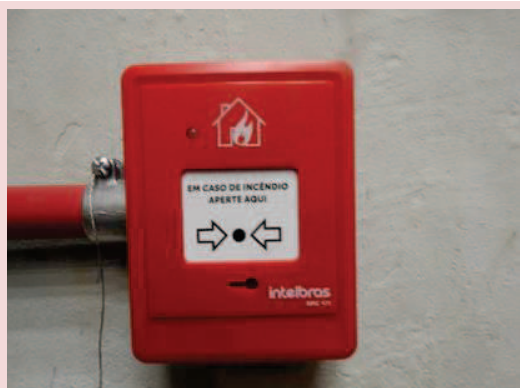
Foto 5-26. Sistema de alerta contra incêndio no interior da casa de força da PCH.
