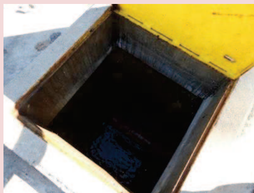
Foto 5-24. Vista interna da caixa SAO na área externa da PCH Cantú 2.
