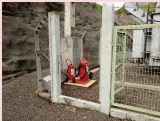
Foto 5-29. Disposição de extintores na área externa da casa de força da PCH Cantú 2 - 2º semestre.
