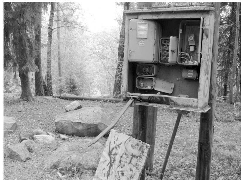
Vandaliserat bortkopplat elskåp
