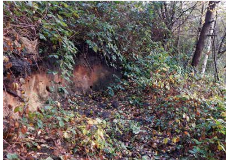
Abbildung 12: Zugewachsene Steilwand vor der Freistellung (16.11.16)
