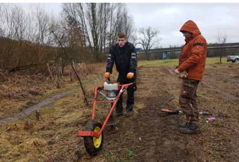
Abbildung 50: Zur Vorbereitung der Gehölzpflanzung in der Heisinger Ruhraue werden mit dem „Pflanzfuchs“ Löcher gebohrt
