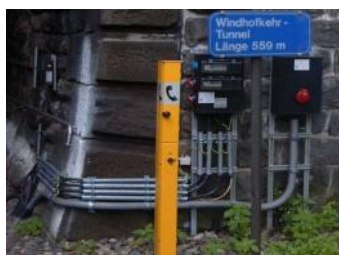
Notruffernsprecher am Portal
