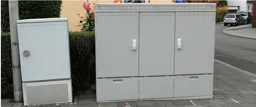
Abbildung 284: Kabelverzweiger (links), Outdoor-DSLAM (rechts) (Wikimedia Commons)
