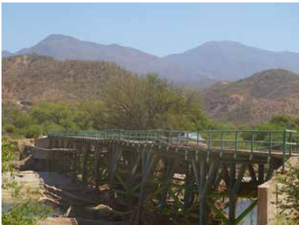
Afb. 6: De beschadigde brug
