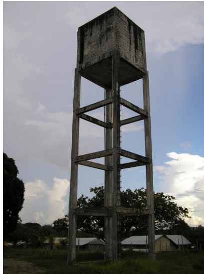
Figura 38. Tanque elevado en Cacahual (sin funcionamiento)
