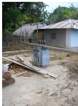
b: transformador en Chaquita (Inutilizado al romperse el poste de madera)
