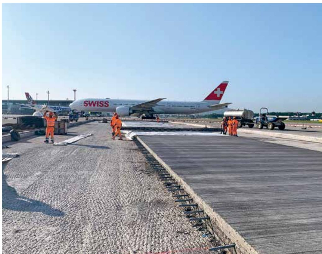
Az újonnan betonozott várakozópálya utókezelése (párazáró szer és azt követő paplanos letakarás)
