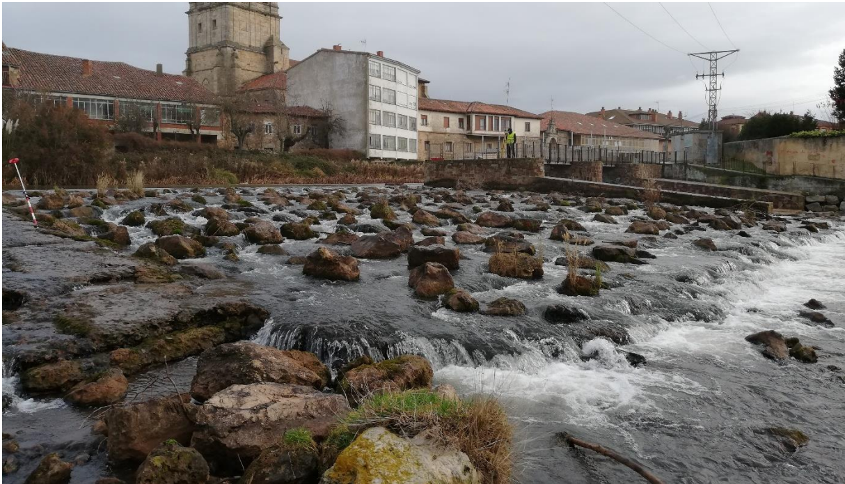
FIGURA 34. RAMPA DE BLOQUES CON DESCALCE DEBIDO A LA AUSENCIA DE UNA POZA DE DISIPACIÓN ADECUADA AGUAS ABAJO, RÍO PISUERGA (AGUILAR DE CAMPOO, PALENCIA).
