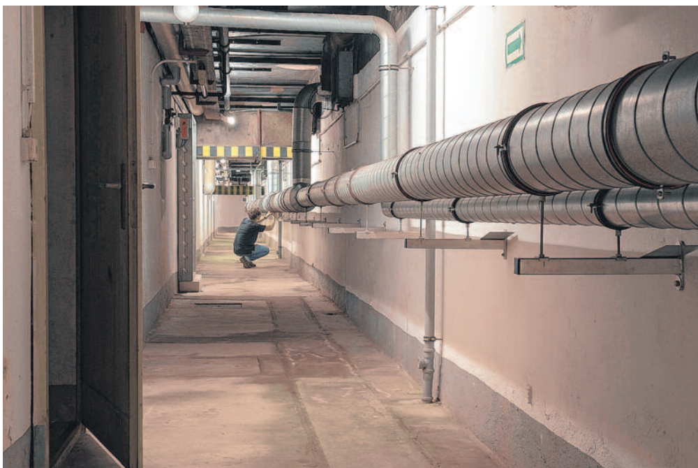
Die Lüftungsrohre in den Katakomben des Stadtbaes. Diese technischen Anlagen des Stadtbaes wurden bereits saniert. Nun stehen weitere Anlagen zur Erneuerung an. Foto: Ulf Dahl
