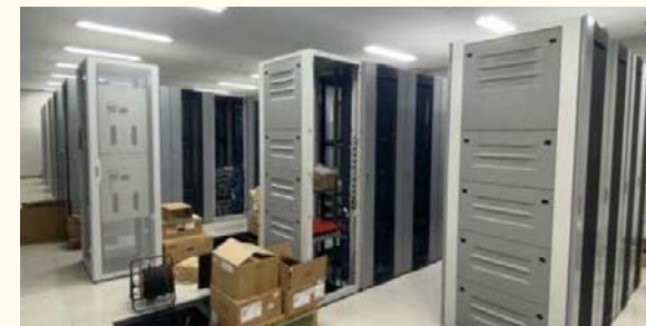
NW機器、サーバ搭載ラック
