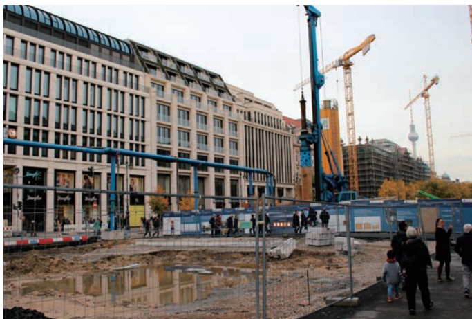
ウンター・デン・リンデンとフリードリヒ通りの交差点周辺 で行われている地下鉄工事（10月13日、筆者撮影）
