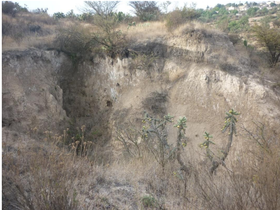
Figura 3. Formación de cárcavas en el manantial el Palomito, se requieren obras de conservación de suelo y agua, reforestación y recuperación de especies nativas.
