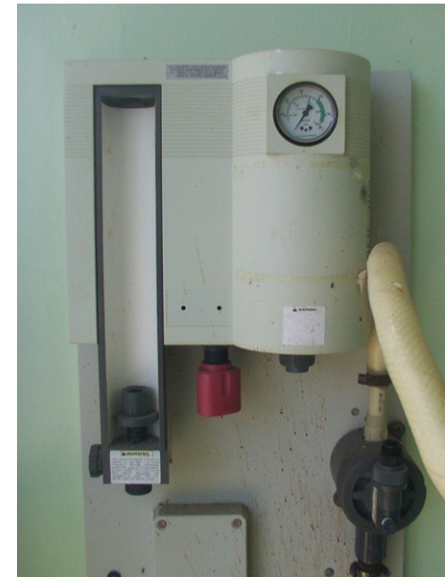
Equipo clorador instalado en Yucatán
