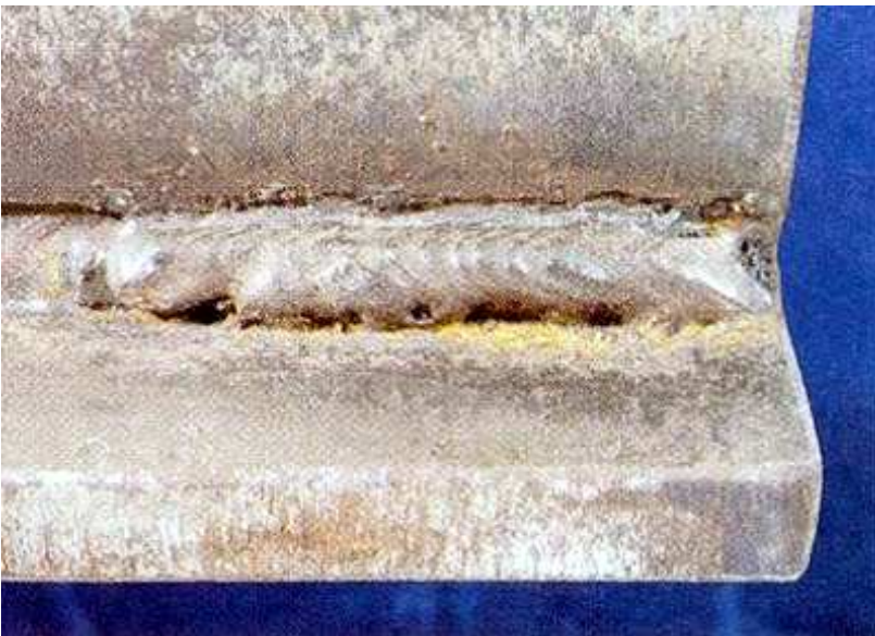
FALTA DE FUSIÓN
