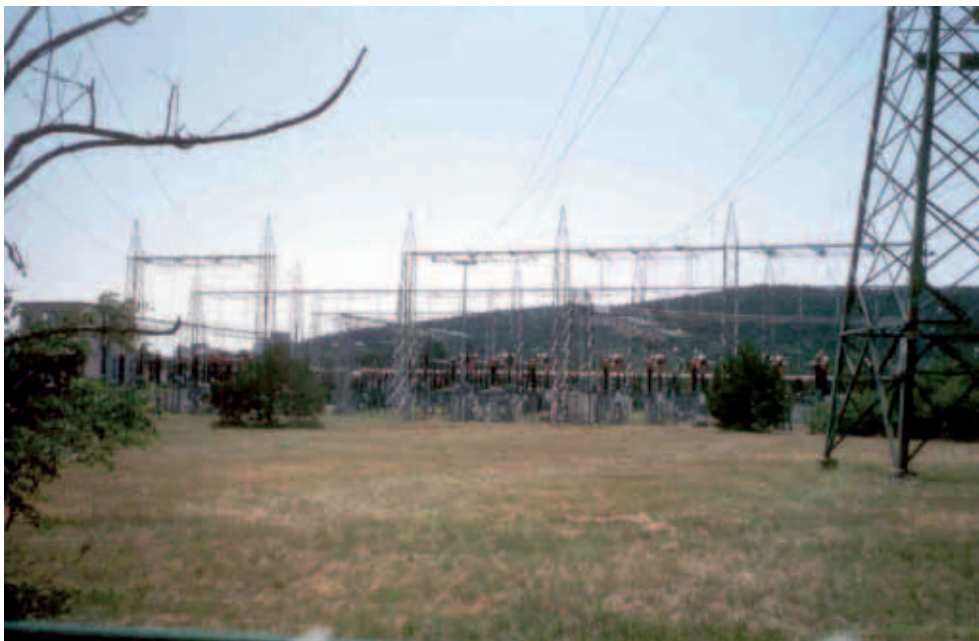
Trasformatori a Padriciano - Trieste
