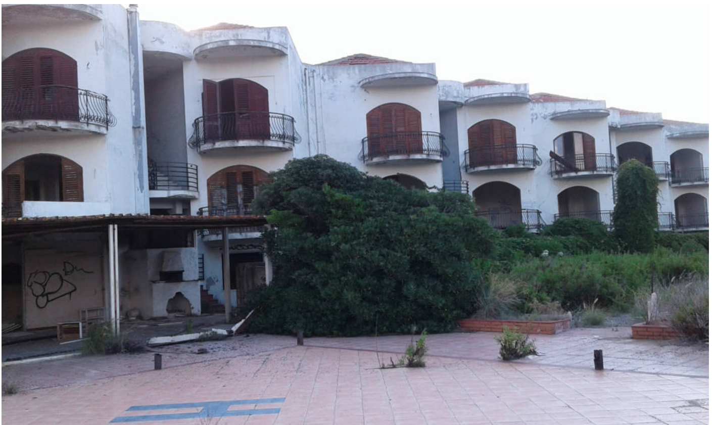
Scorcio dello stato di abbandono dell'ex Motel Faro
