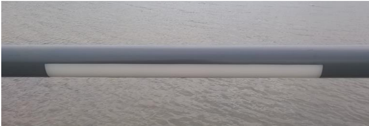
Figuur 3: Voorbeeld verlichting in brugleuning – project “Punt West”
