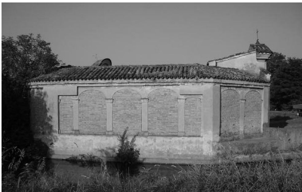
Figura 21. – Il lato Ovest affiancato dalla Roggia Cremasca. Le arcate esterne, una volta aperte, furono tamponate con mattoni pieni lasciati a vista.
