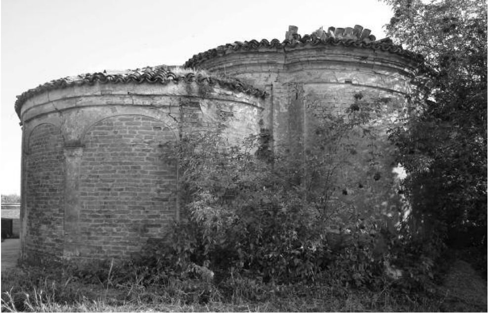
Figura 29. – Nel lato rivolto a nord è ben visibile il volume curvilineo della cappella. La copertura abbisogna di urgente riparazione per evitare danni alla volta.
