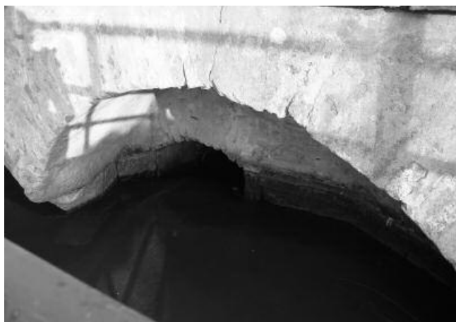
Figura 12. La chiavica centrale che origina il Bocchello di Capergnanica. L'arco presenta una forte strombatura che riduce la quantità d'acqua convogliata.
