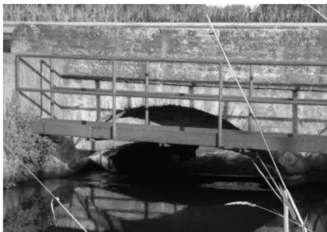
Figura 11. La chiavica di sinistra che convoglia parte delle acque nel proseguimento della Roggia Cremasca.
