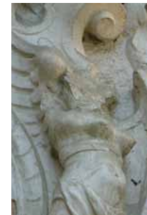
5. Piazza Duomo. Particolare dello stemma danneggiato
