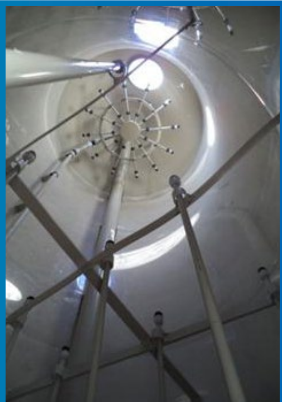
fig. 10 - Interno di torre con particolare degli ugelli di lavaggio
