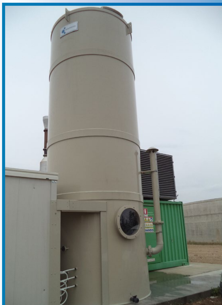
fig. 3 - ECOCHIMICA BIO-DESOLF® installato in Turchia
