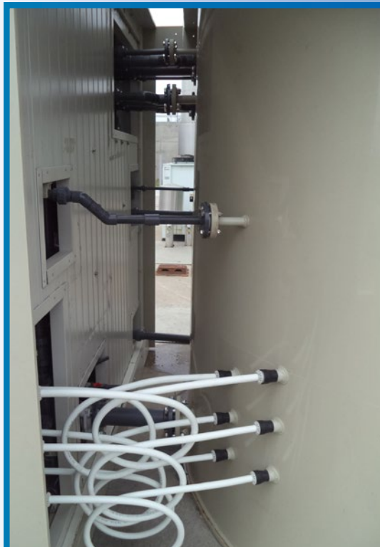
fig 11 - Collegamenti tra stazione di controllo e torre BIO-DESOLF®
