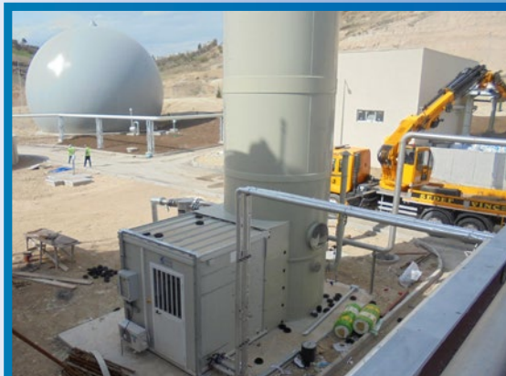
fig 1 - Dettaglio Stazione di Controllo del BIO-DESOLF® in impianto di digestione anaerobica
